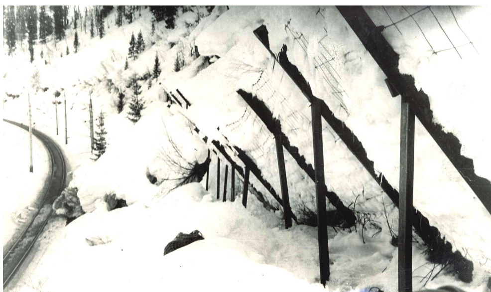
Рис. 2. Снегоудерживающие сооружения на склоне
