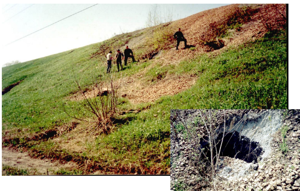
Рис. 3. Воронки провалов в откосе насыпи над водопропускной трубой
