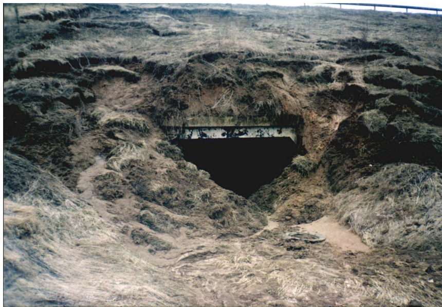
Рис. 1. Оползание откоса насыпи над трубой на 101-м км автомобильной дороги Воронеж — Луганск
