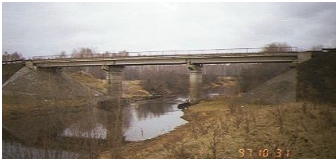
Рис. 2. Общий вид моста до разрушения
