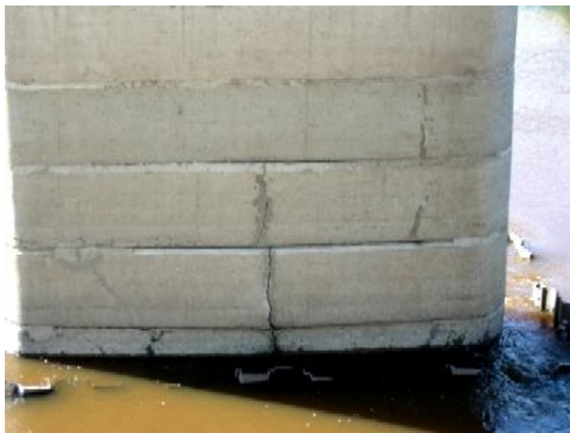
Рис. 4. Трещины в контурных блоках опоры № 2 на стадии эксплуатации
