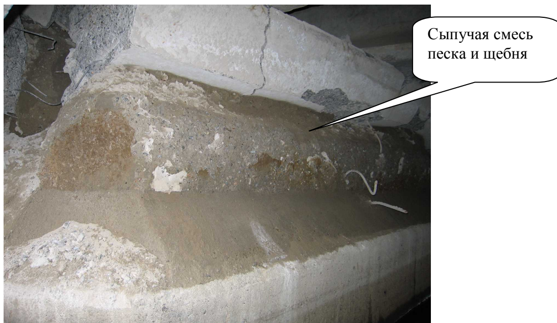
Рис. 6. Опора № 3. Слой сыпучей смеси разрушенного бетона ядра заполнения
