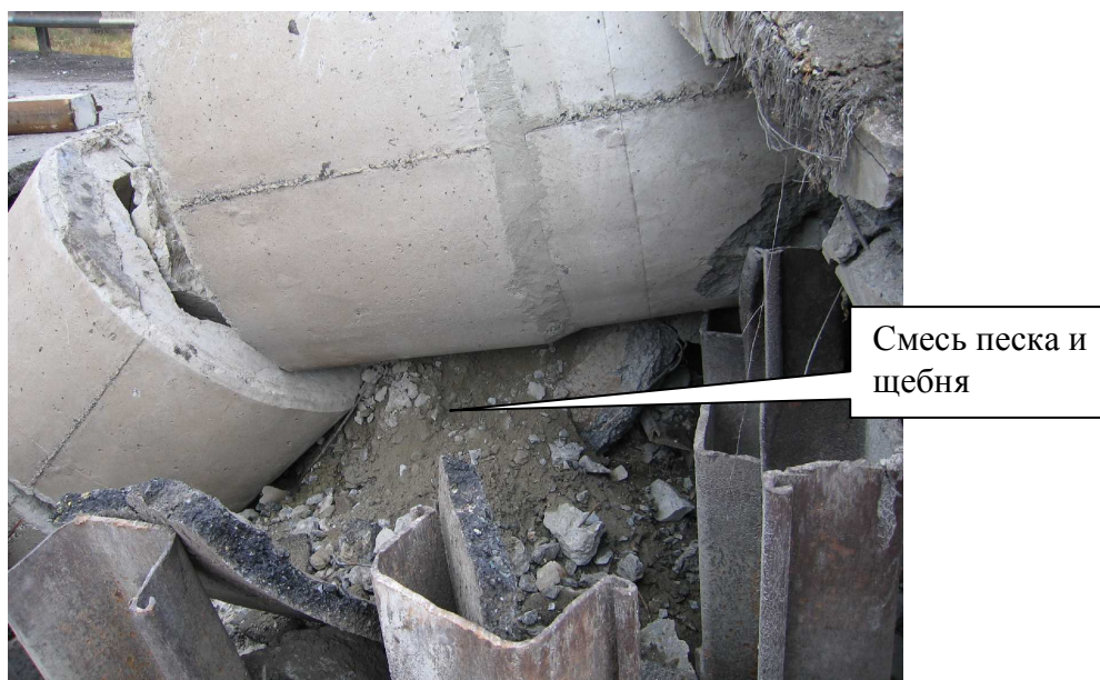
Рис. 5. Обломки опоры № 2. Остатки бетона ядра заполнения в виде смеси песка и щебня
