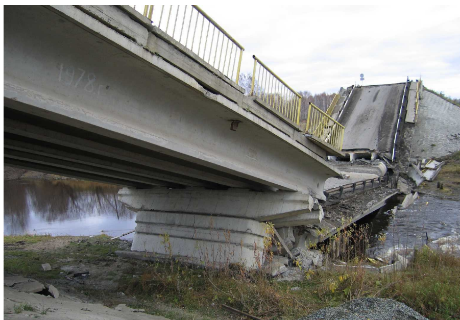
Рис. 3. Вид моста после обрушения
