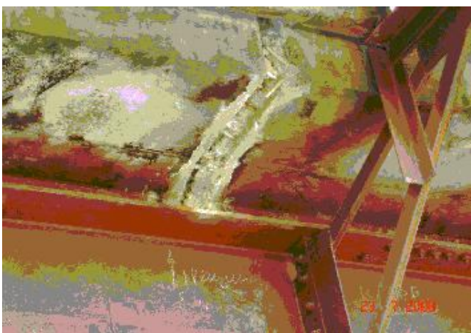
Рис. 1. Разрушение швов омоноличивания железобетонной плиты: а — трещина по контакту бетона омоноличивания швов и бетона блоков плиты; б — разрушение бетона омоноличивания швов
