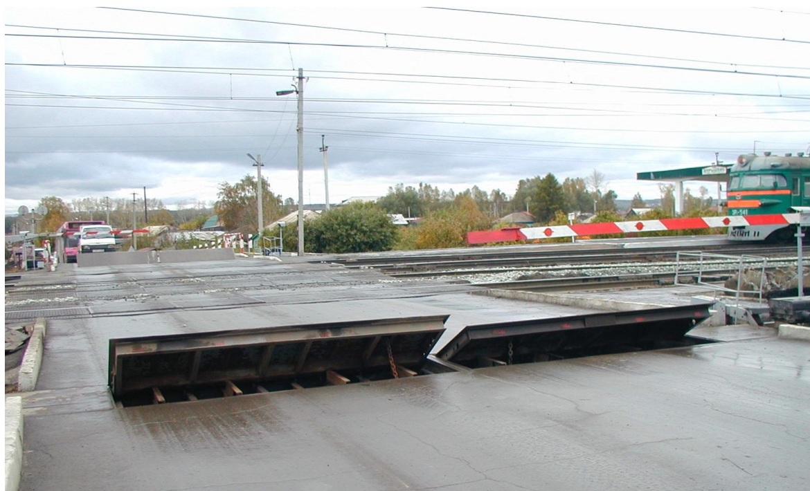
Устройство заграждения переезда
