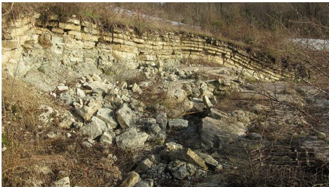
Рис. 5. Оползень на южном портале ТК № 1
