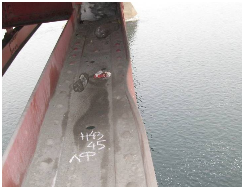
Рис. 3. Характерное повреждение нижнего пояса
