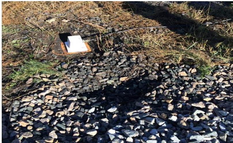
Рис. 2. Трехкомпонентный сейсмометр, установленный на основной площадке земляного полотна подходной насыпи
