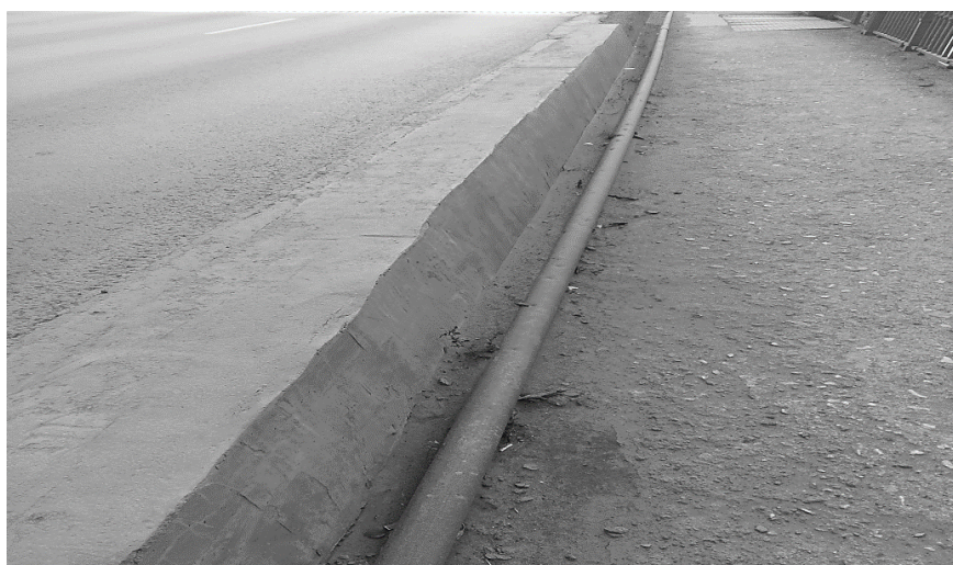
Рис. 10. Парапетное ограждение на Коммунальном мосту г. Новосибирска спустя 1,5 года после ремонта с обработкой гидрофобизирующими пропитками
