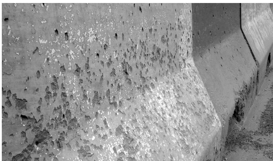
Рис. 2. Шелушение поверхности блоков дорожного ограждения на автомобильной дороге, ведущей к аэропорту Толмачево в Новосибирском районе
