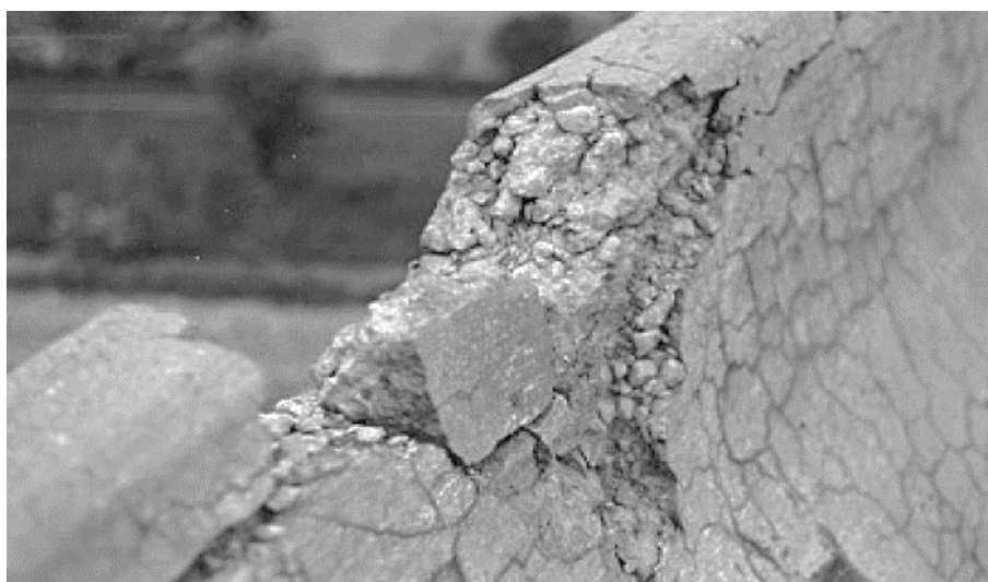
Рис. 4. Разрушение цементобетонного ограждения в результате воздействия окружающей среды на мосту через р. Гурон в округе Washtenaw (штат Мичиган)
