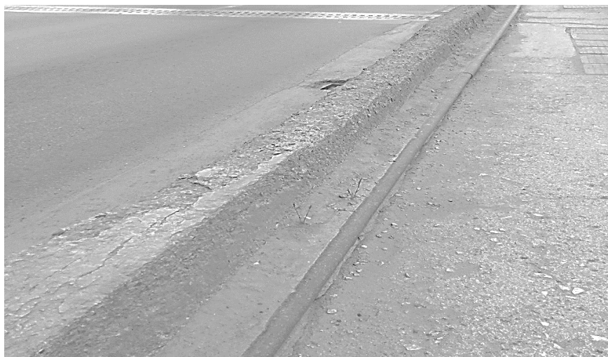
Рис. 9. Разрушение цементобетонного парапетного ограждения на Коммунальном мосту г. Новосибирска до ремонта
