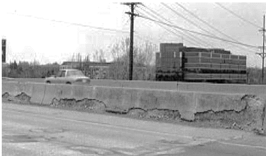
Рис. 3. Разрушение ограждения парпетного типа из цементобетона на автомобильной дороге Alward Road в округе Клинтон (штат Нью-Йорк)
