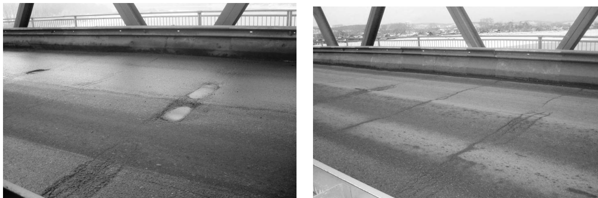
Рис. 4. Состояние покрытия Байдаевского моста в 2007 г.
