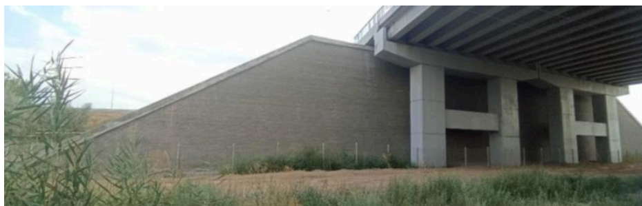
Рис. 4. Состояние подпорной стены на сегодняшний день
